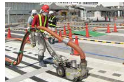
先端洗浄ユニット(スピンジェット)
